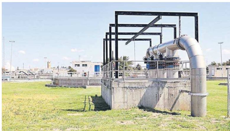
Imagen de la estación depuradora de Jerez.
